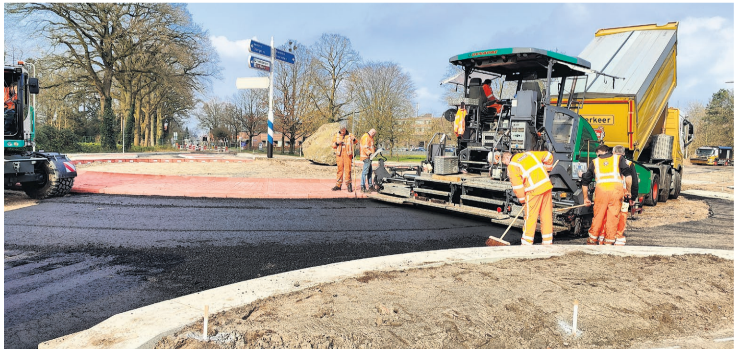
Wegwerkers leggen de laatste hand aan de rotonde op de kruising met de Wiedenbroeksingel en Enschedesestraat.
