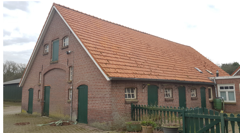
foto 7: Linkerzijgevel met de oude stalramen en staldeuren. Eveneens als het rechterdakvlak vertoont ook het linkerdakvlak vormen van doorbuiging. De zijgevel loopt over in een plat dak.
