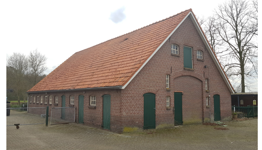
foto 5 : Rechterzijgevel met aan de voorzijde houten raamkozijnen en aan de achterzijde de voormalige staldeuren van de grupstal. Het dakvlak hangt op grote delen door. Vermoedelijk door het wegvallen van de gebintconstructie. Aan de voorzijde zijn enkele waarschijnlijke deuropeningen en vervangen voor raamkozijnen.
