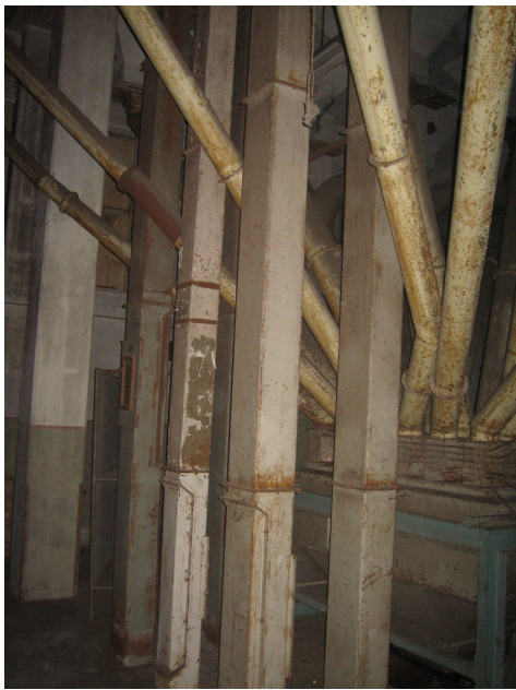
^ de menginstallatie op begane grond silo
