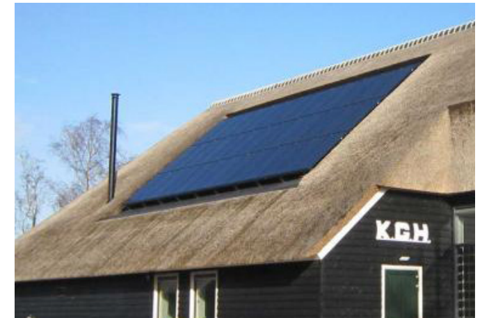
Zonnepanelen verzinkt in het rieten dak
