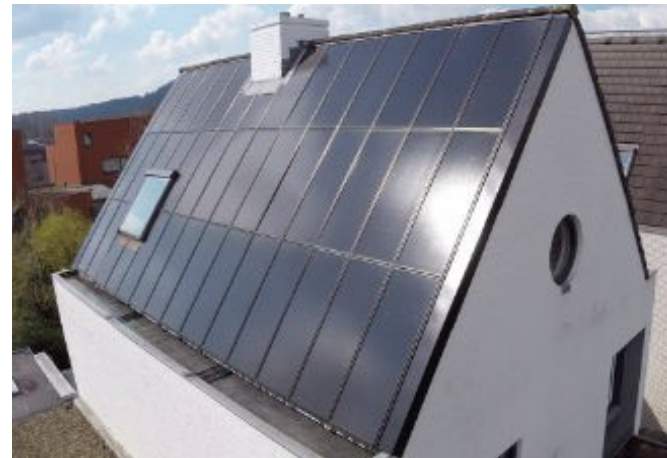
Het hele dakvlak bedekt met zonnepanelen
